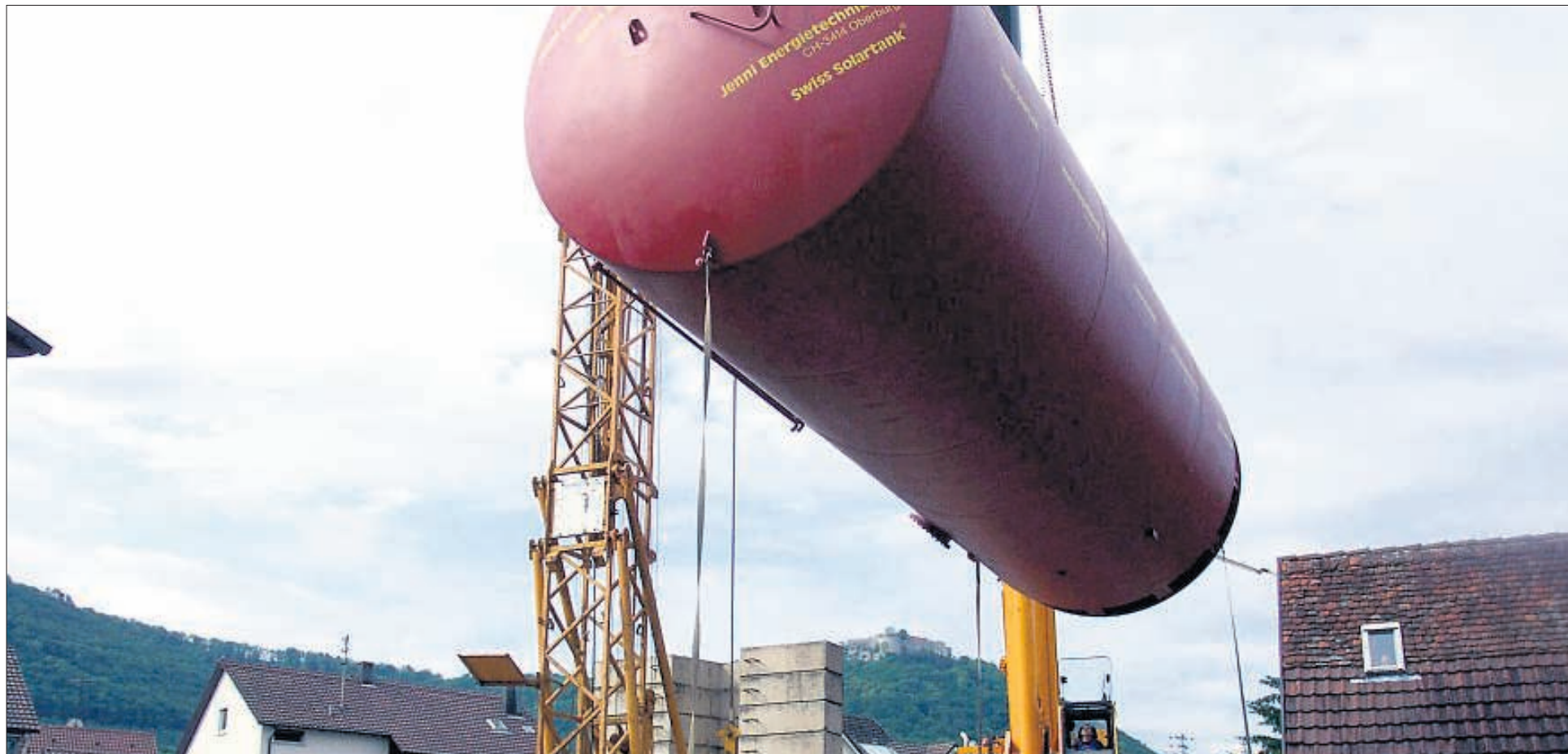
104 000 Liter Wasser fasst der Solarspeicher, der in Beuren bald übers ganze Jahr ein Mehrfamilienhaus mit Heizung und Warmwasser versorgt.
